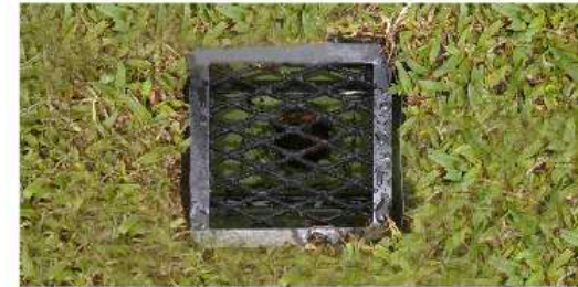
Figura B / Desagüe con rejilla
